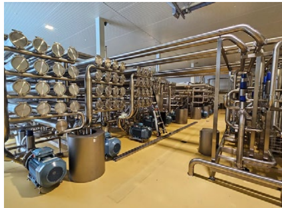
La nouvelle usine UF/RO de Langemark a été mise en service en 2023.
