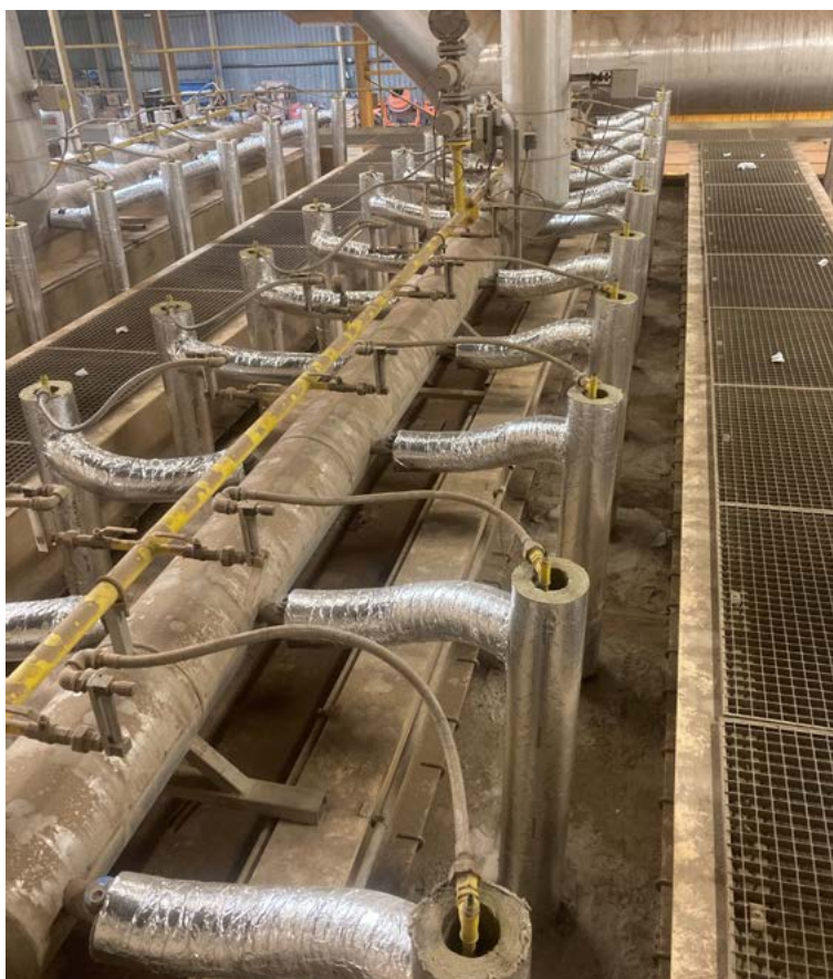
Les brûleurs des fours ont été isolés.
