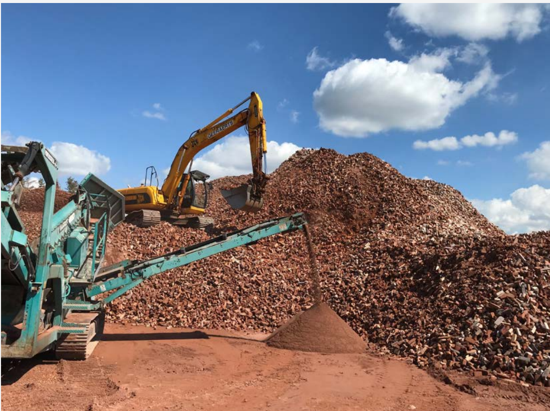
Les gravats de terre cuite sont traités sur le site de notre usine.
